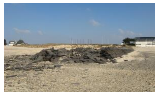
La digue malmenée par les tempêtes
